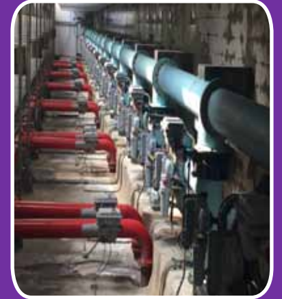
محطة مياه السويس
