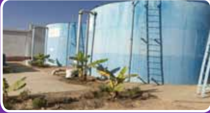
خزانات مياه لمحطة البحيرة
